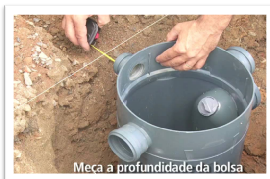
Figura 16 – Detalhe da instalação de uma Caixa de Gordura Fonte: NBR8.160/1999 - adaptado por SAMENCO (2019)
