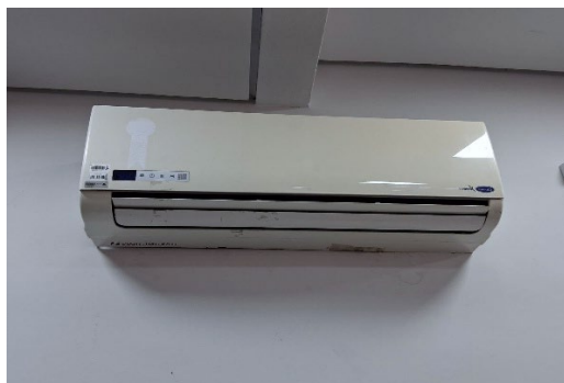
Figura 4 – Ar-condicionado Setor Técnicos Rio Vivo (Sala multidisciplinar)
