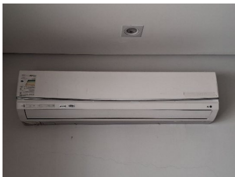
Figura 2 – Ar- condicionado Sala Compras
