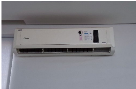
Figura 1 – Ar-condicionado Sala de Reuniões AGEDOCE
