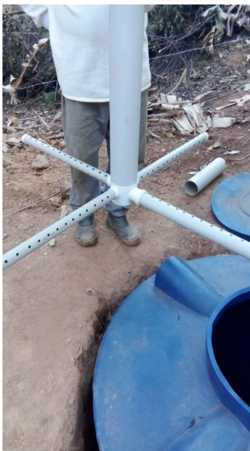
Figura 4 - Sistema de tubulação do Filtro Anaeróbio Fonte: COBRAPE (2024).
